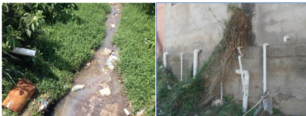
Figura 11: Lançamento de esgoto in natura no Córrego do Lenheiro Fonte: Acervo do autor
